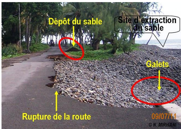
Photo 63- Apparition des galets et rupture de la route près d'un site d'extraction de sable marin à Pomoni
