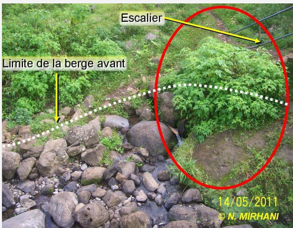
Photo 39- Une berge reliant les escaliers du pont de Djidjini stabilisée avant les pluies diluviennes du 18/04/12 (Ouzini)
