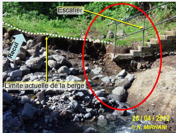
Photo 40- Recul de la berge et érosion du substrat des escaliers du pont de Djidjini par les crues extrêmes du 18/04/12 (Ouzini)
