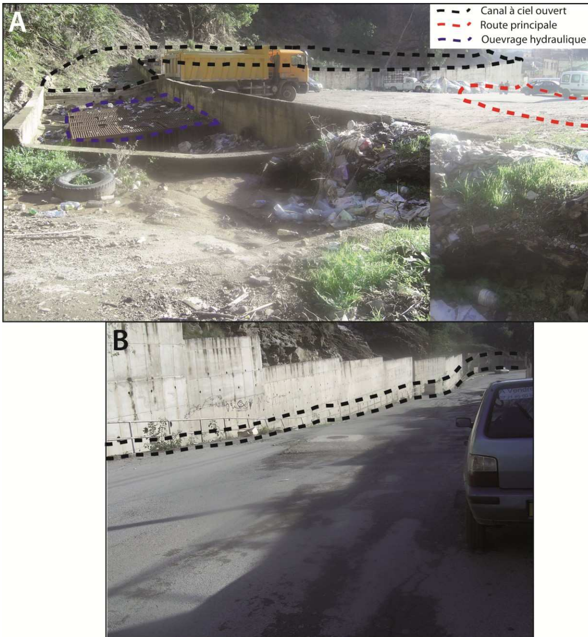
Fig. 7.10. Collecteur à ciel ouvert. A : en aval de l'ouvrage Jaubert ; B : le long de la route qui traverse le quartier ; C : Encombres et embâcles formés par différents matériaux.
