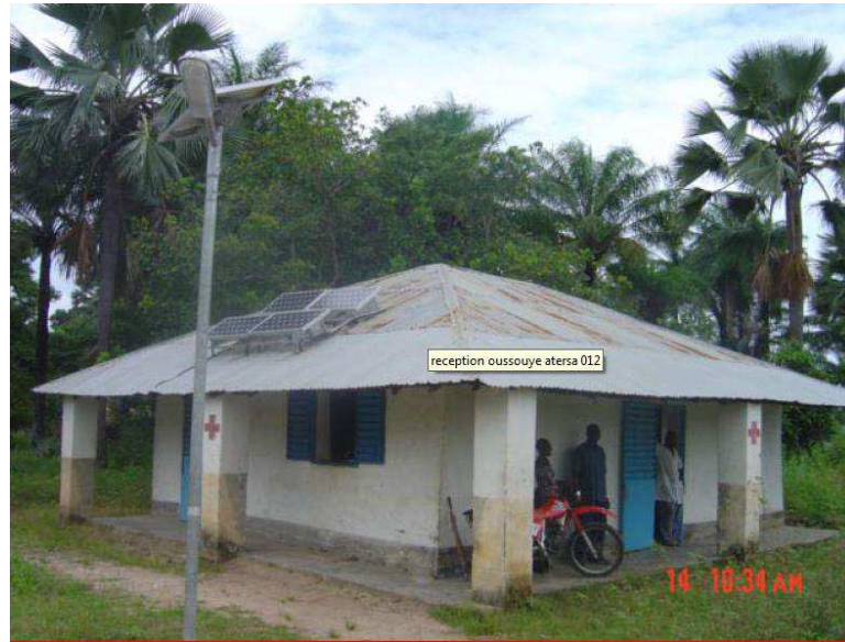
Figure 1.20: Case de santé équipée de panneaux photovoltaïques montés sur le toit à Oussouye au sud du Sénégal
