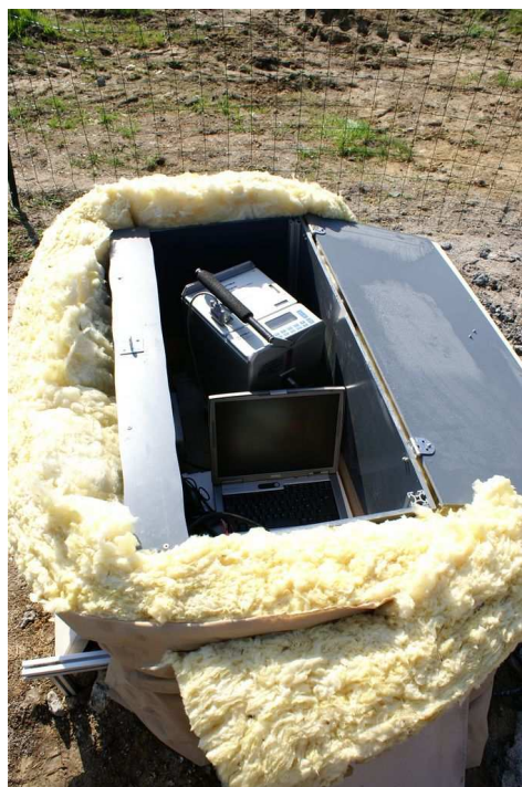
Photo 4 : Site Gr5, CG3M 424 Noter la laine de verre pour l'isolation thermique
