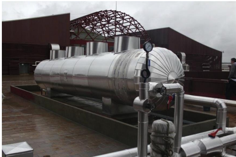
Figure II-54 : Prototype de stockage pour une installation de refroidissement solaire construit sur le toit de l'université de Lleida en Espagne [109]
