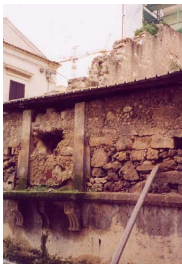
Cliché 5.16. Une des ruines de la Via Ducezio à Noto. Un mur de comblement sommaire surmonte une assise plus ancienne et de plus grande qualité patrimoniale.
