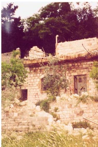
Cliché 5.15. Une habitation en ruine dans les hauteurs d'Assise.
