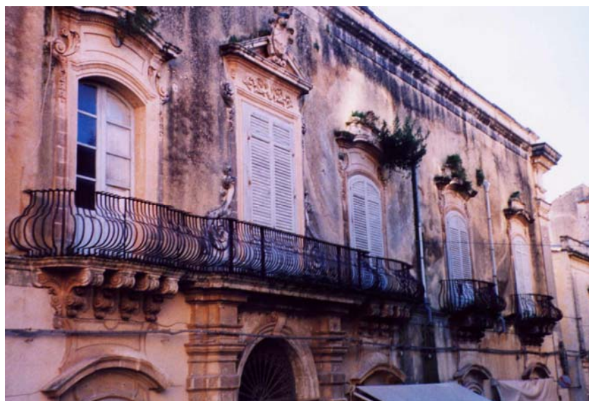
Cliché 1.6. La façade du palais Rau à Noto, avec de la végétation installée dans les fissures.
