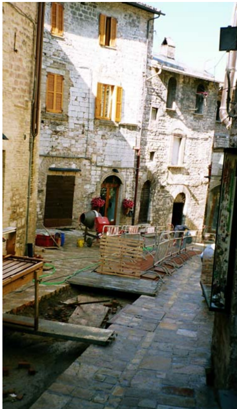
Cliché 5.9. Travaux systématiques d'enterrement des réseaux de fils et conduits dans une rue à Assise.
