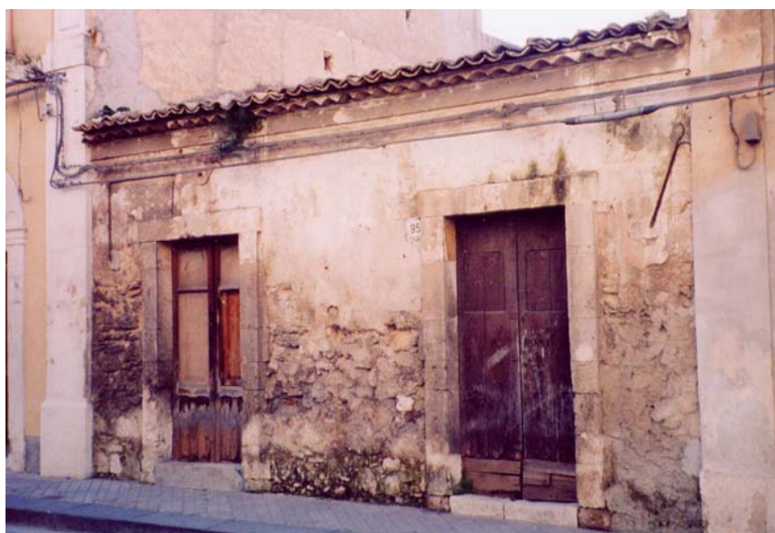
Cliché 1.5. Une habitation abandonnée dans la Via Ducezio à Noto.
