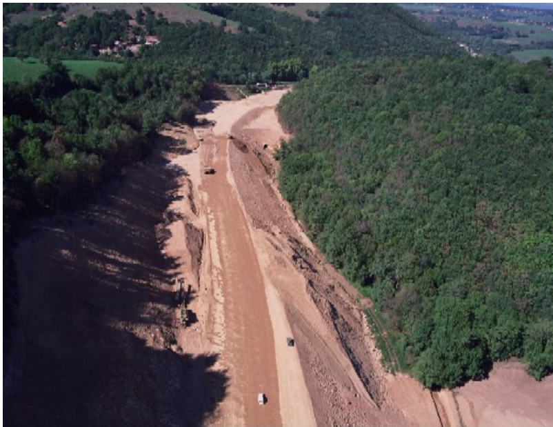
Figure 22. Vue du chantier de déboisement et terrassement pour la mise à 2*2 voies de la RN7 - RN 82 à Vendranges (crédit photo DDE 42)
