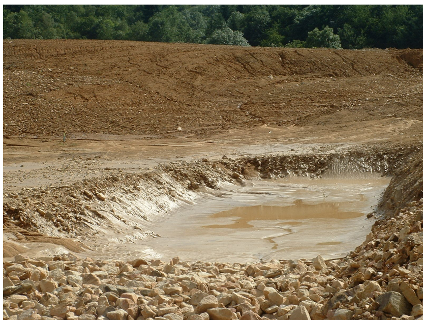
Figure 23. Bassin de rétention provisoire mis en place, dans le cadre de la démarche de management environnemental, sur le chantier de la mise à 2*2 voies de la RN7 - RN 82 à Vendranges
