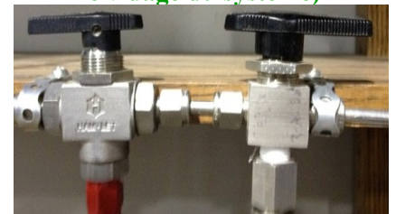
Figure G.6 : Vannes d'alimentation ne position "fermée" (pendant la recirculation)
