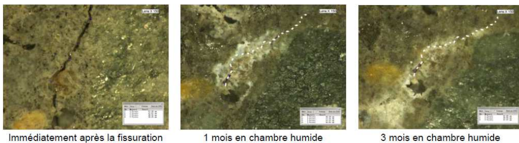
Figure 39. Observations au MEB de la fissure (64 \mu\text{m} ) placée en chambre humide pendant 1 et 3 mois ([Argouges, 2009])
