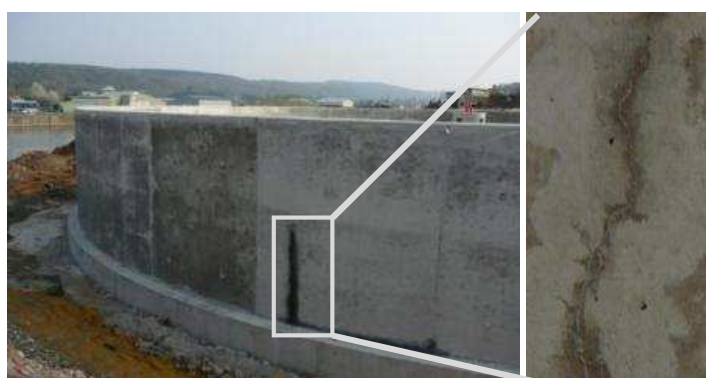
Figure 1. Fissuration au jeune âge et auto-cicatrisation de la fissure
