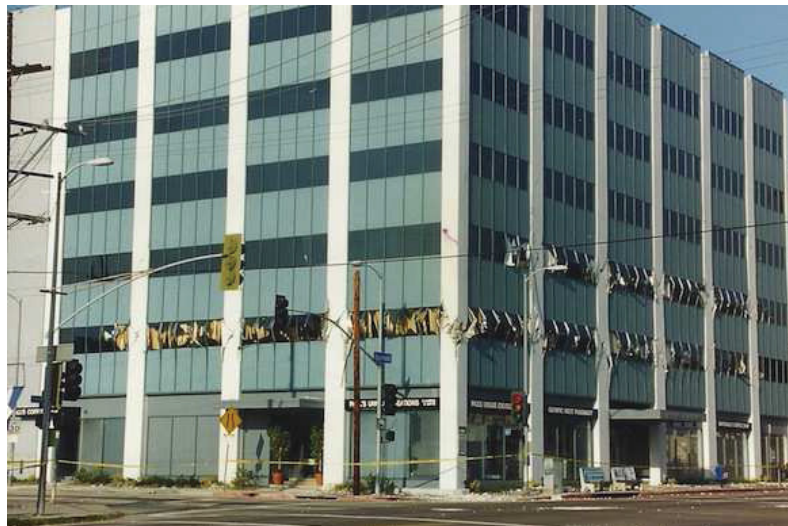
Figure 2.1 – Dommages aux faces sud et ouest de l'édifice Barrington (Photo par Comartin [18])
