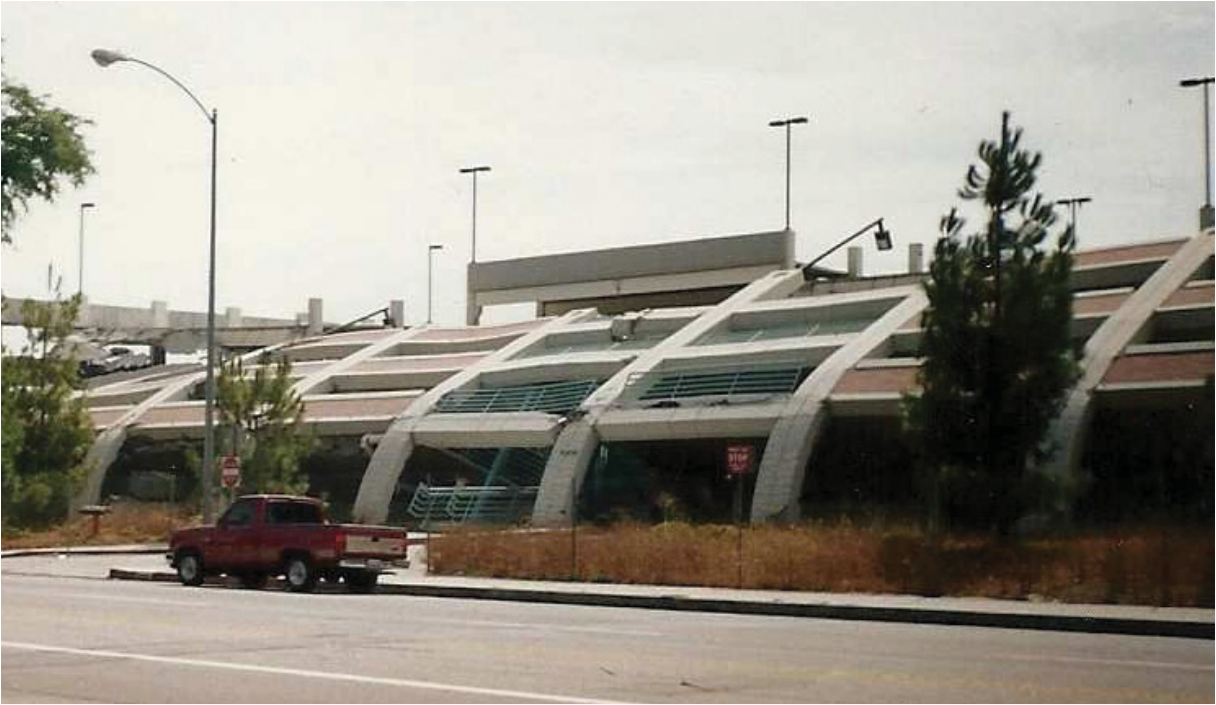
Figure 2.2 – Déformations dans les poteaux extérieurs de la structure de stationnement de la California State University (Photo du domaine public, commons.wikimedia.org )
