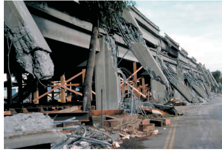
(b) Viaduct Cypress Street à Oakland, Loma Prieta (1989) (Photothèque USGS).
