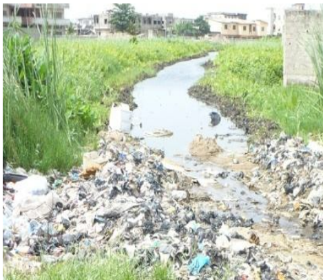
Figure 3.7 Tranchée provisoirement creusée, encombrée par des déchets
