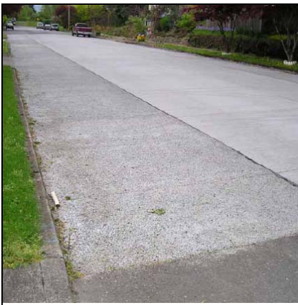
Figure 4.3 Bande d'asphalte perméable dans une avenue résidentielle de Portland Tirée de Portland (2007) Green streets tour map
