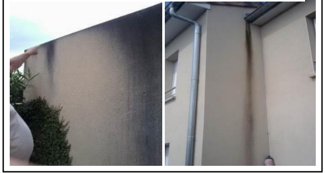
Photo 11 : Traces d'humidité liées à un défaut d'étanchéité
