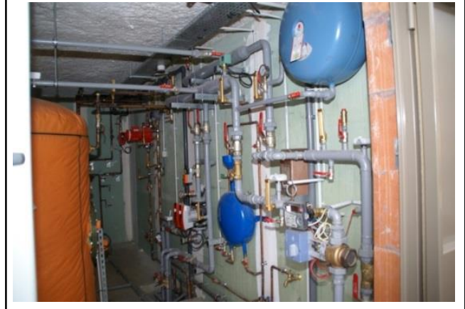
Photo 2 : Sous-station eau chaude collective
