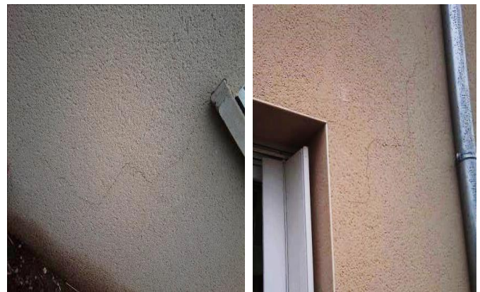
Photo 9 : Fissures sur le mur extérieur
