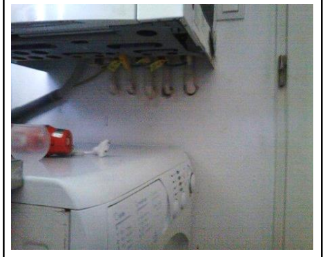
Photo 10 : Chaudière placée dans la cuisine
