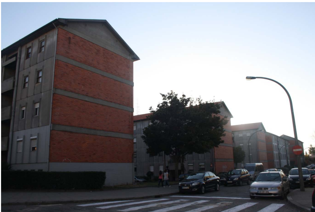
Figura 153 – Aspecto de degradação dos topos voltados a Norte do bairro do Bom Pastor (Fotografia pelo autor)
