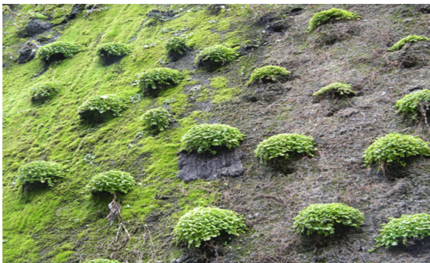
Figura 96 - Algumas plantas da parede encontram-se mortas, por causa de eventuais falhas no sistema de rega (Retirado de: Velazquez, 2011)
