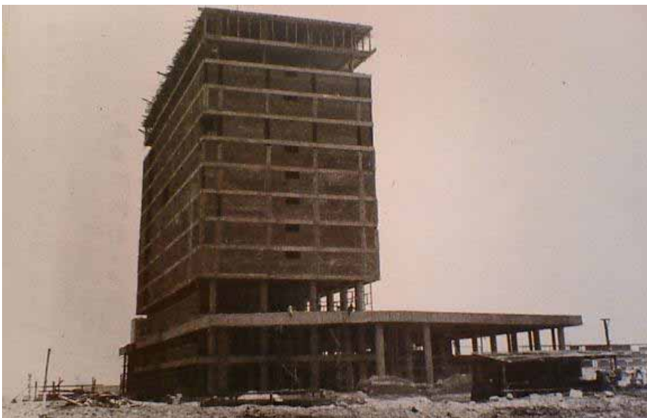
Figura 87. Etapa de la construcción de la biblioteca central, cortesía de Nicolás Cruz Cruz
