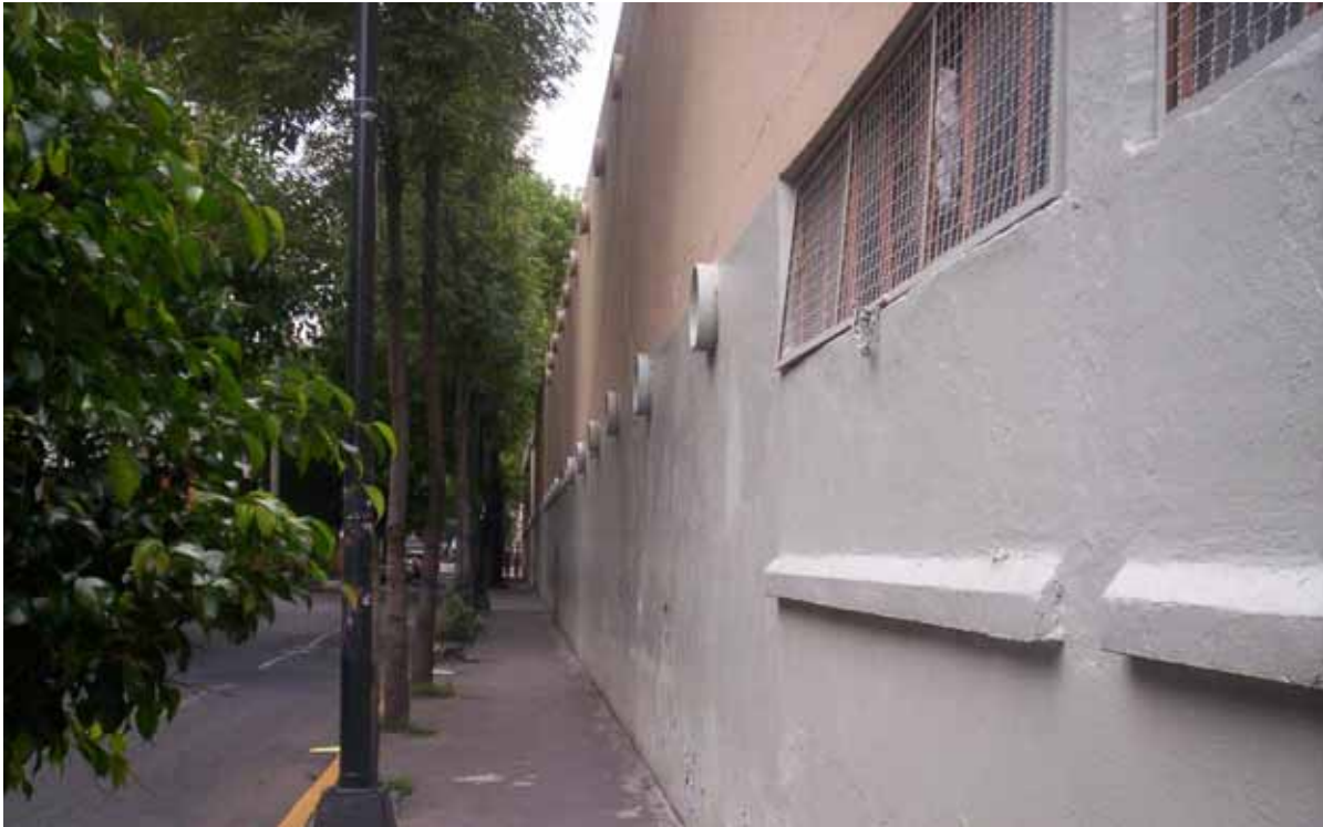
Figura 52. Fachada lateral que muestra el sistema de ventilación propuesto por O’Gorman. En la escuela Pedro María Anaya.
