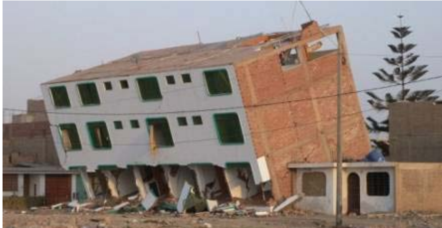
Photo n°18 : Bâtiment effondré à Pisco
