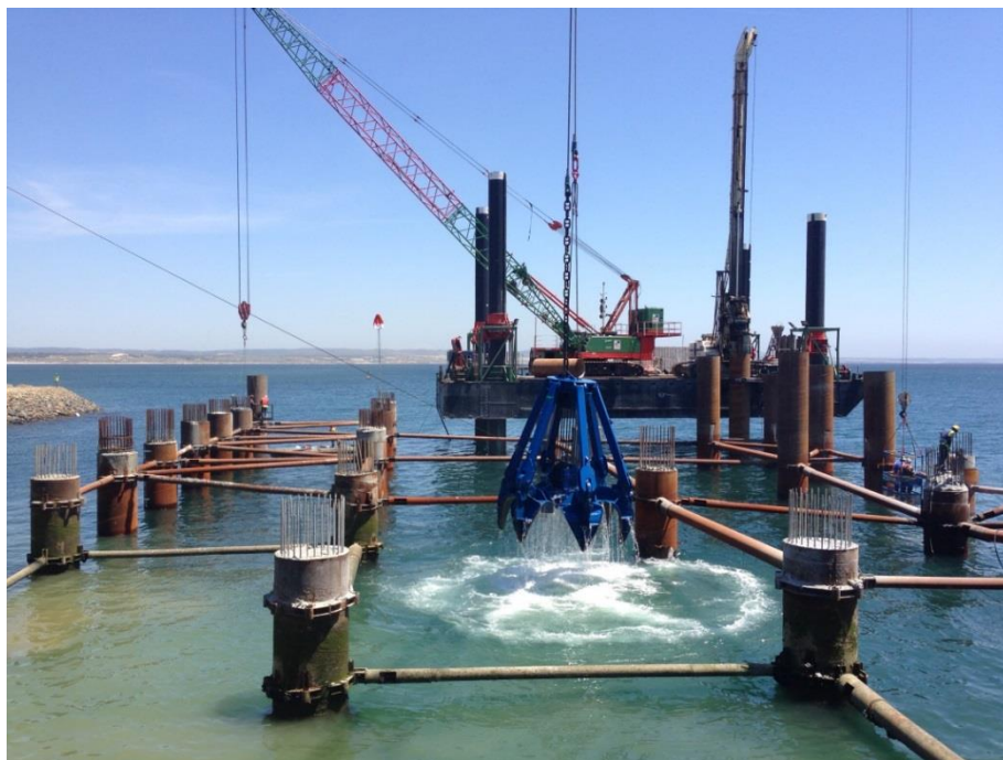
Figura 82 - mandíbula do tipo Orange peel adaptado na grua de rastos par a execução da camada de filtro
