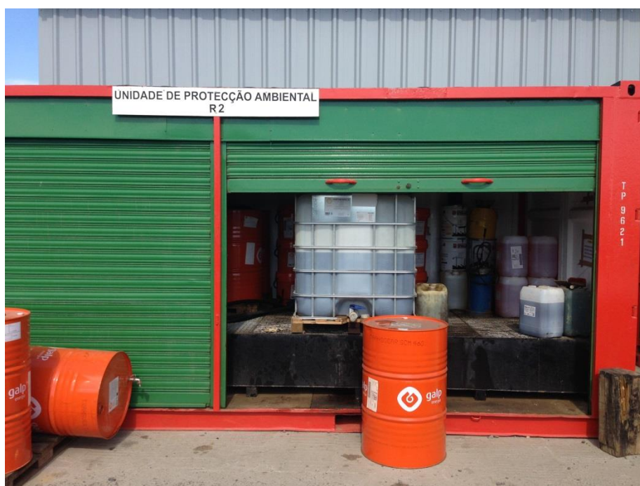
Figura 118 - Unidade de protecção ambiental
