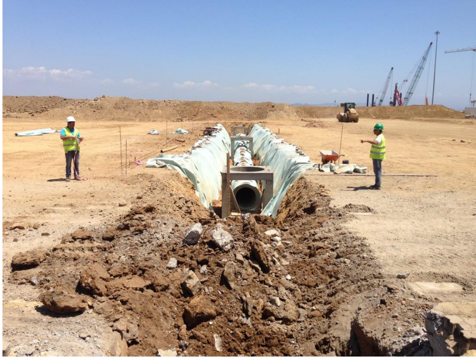
Figura 104 - Abertura de vala para implementação da rede de drenagem de águas pluviais
