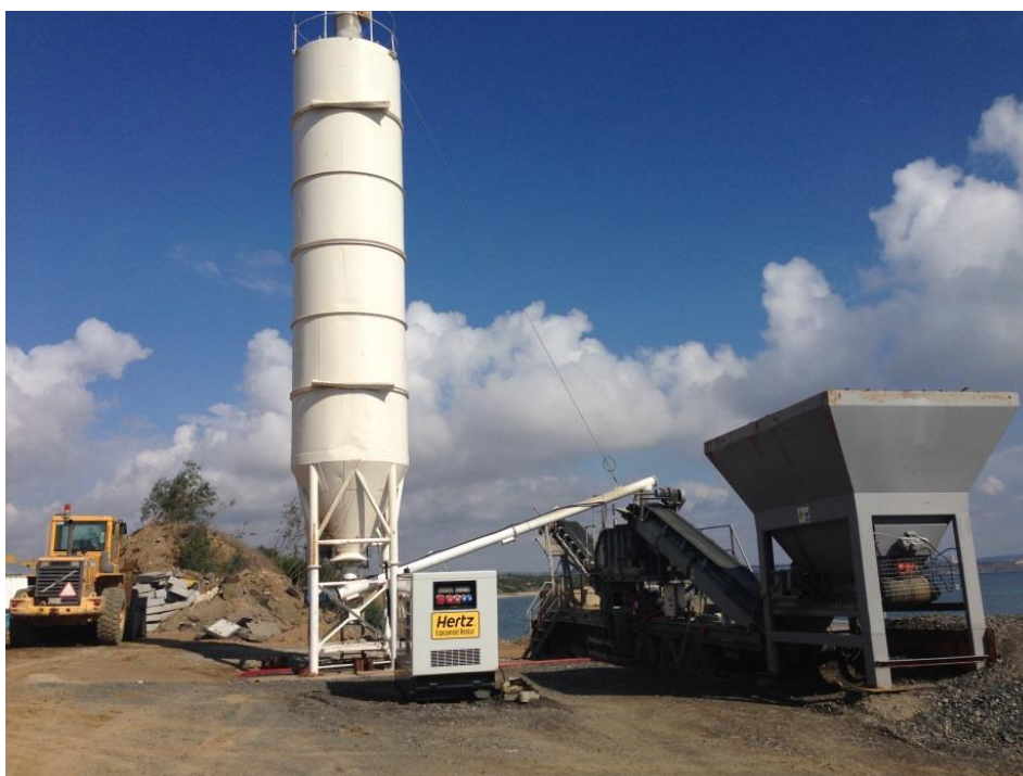
Figura 107 - Vista geral da central de solo-cimento
