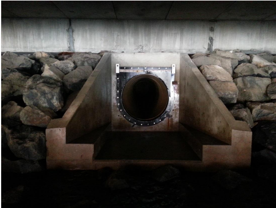
Figura 106 - Boca de Lobo do interceptor dos ramais de drenagem da plataforma 5
