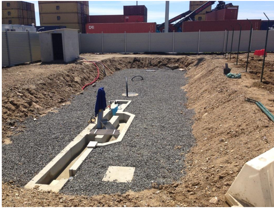
Figura 119 - Mini-ETAR para tratamento das águas residuais do estaleiro
