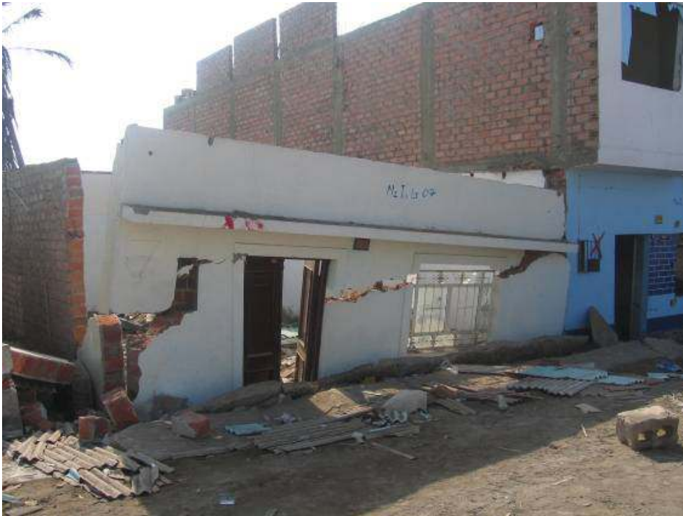
Photo 8 - Effets du phénomène de liquéfaction du sol sur une maison de Tambo de Mora (province de Chincha)
