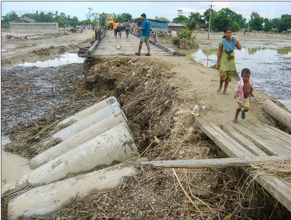
Illustration 6 - Une route majeure dans le district de Lakhimpur est rompue. Un pont temporaire a été installé, pendant qu'un autre en béton est en cours de construction
