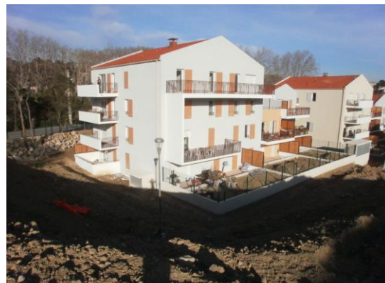
Des ERF encore en construction, projets Collinéo Cap Aldéa, ZAC de Ste Marthe, G. Audren, 2013.
