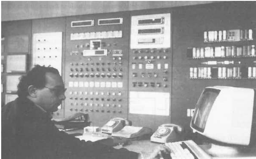
Figure 1 : Exemple de salle de supervision (Photothèque DETN - GAZ de FRANCE)
