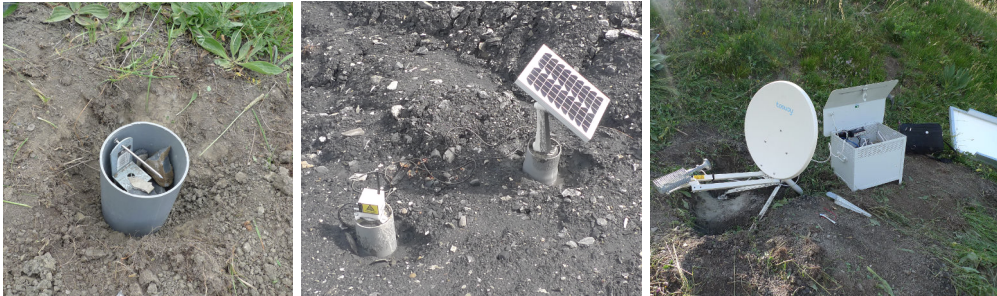
FIGURE 3.3 – Installation des Geocubes et du coordinateur à Super-Sauze (photos : O.Martin).
