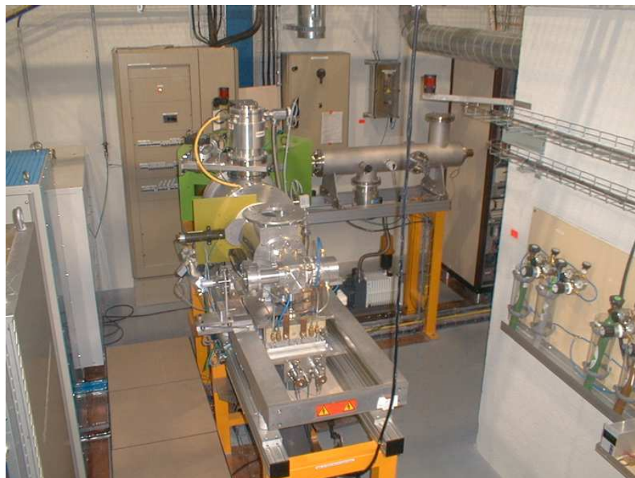
Photo N° 16: Vue d'ensemble et ECS N°1
