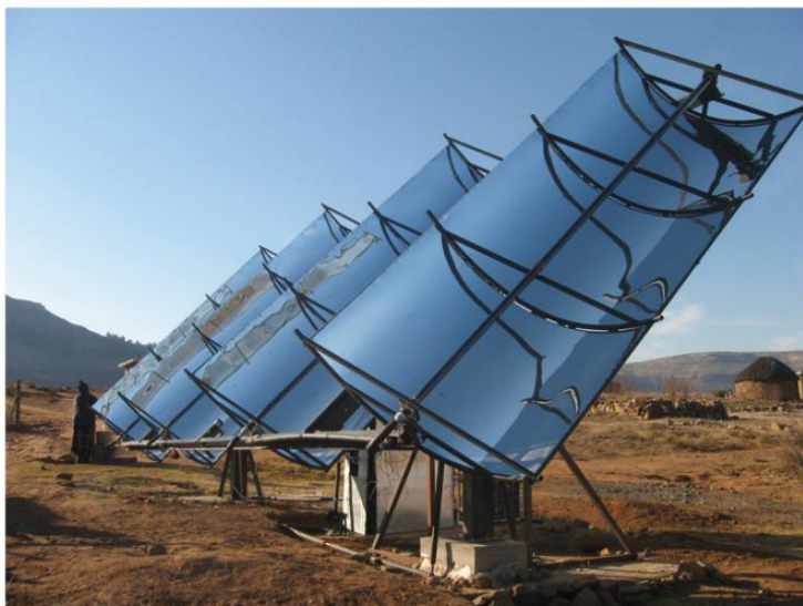
Εικόνα 3.4 – Συλλέκτης εγκατάστασης στο Lesotho (S. Quoilin, 2011)
