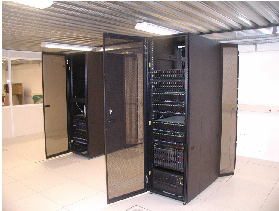
Fig. 1.13: La salle machine accueillant le projet Grif au LPNHE.
