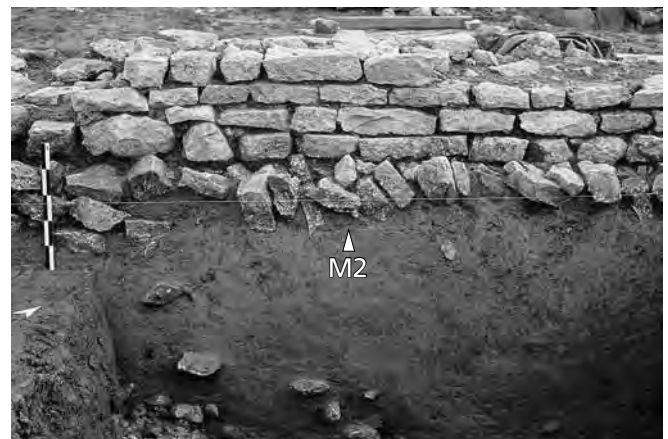
Fig. 117. Alle, Les Aiges, phase 3. Vue de la face interne du mur M2, dans la partie haute du bâtiment 3. Au-dessus d'une unique rangée de blocs de fondation ont été agencées deux assises de réglage, surmontées de deux assises d'élévation conservées.
