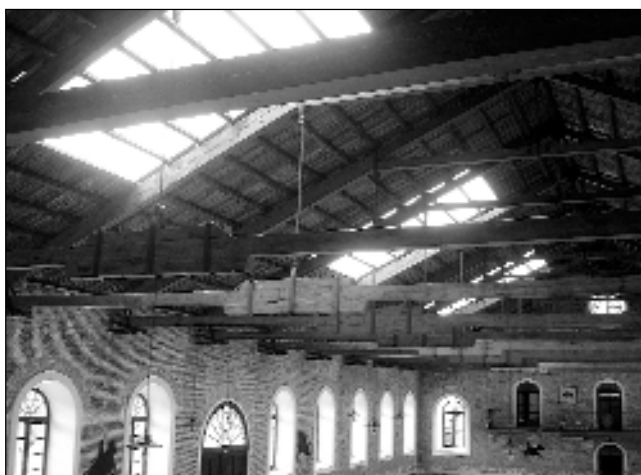
Sistema de «Cerchas», que soportan la techumbre del edificio. A la izquierda, se puede apreciar la puerta de acceso del lado sur
