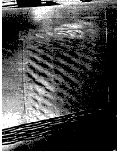
FIGURE 1.14: Exemple de flambement de panneau
