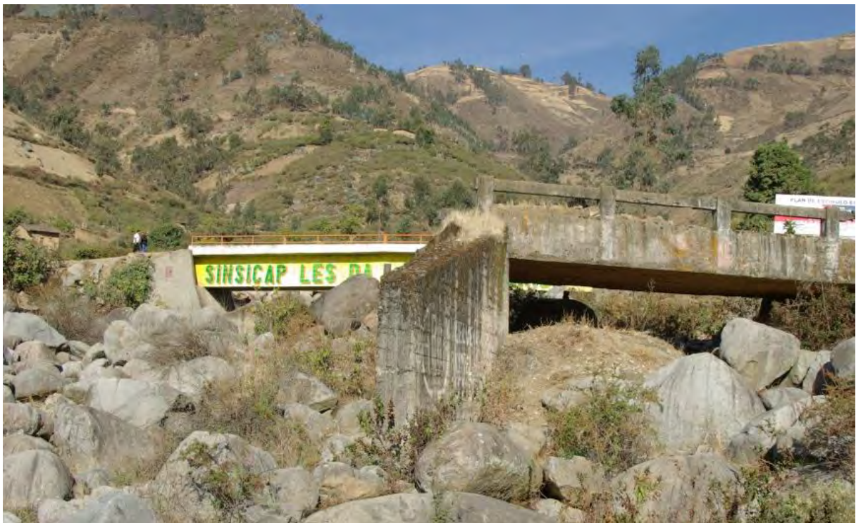
Figure V.12. Photo en direction du Nord, illustrant le régime torrentiel affectant les contreforts de l'escarpement de la côte, au niveau de la commune de Sinsicap (Figure V.13). Deux ponts ont été détruits (premier plan et en aval) avant la construction du troisième (en 2005, arrière-plan). Sinsicap, district de Trujillo, province La Libertad, nord Pérou.
