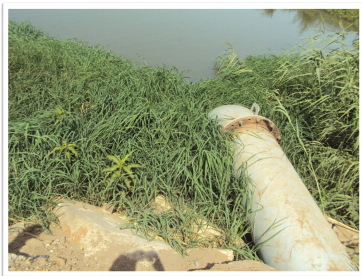
Figure 5: Un point de déversement des eaux usées de la CSS dans le Lac de Guiers. Photo prise par Dione Y.
