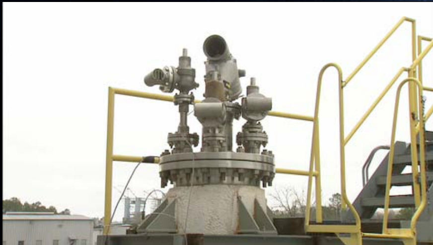
S-IVB Vent Relief Valve Test MSFC, AL
