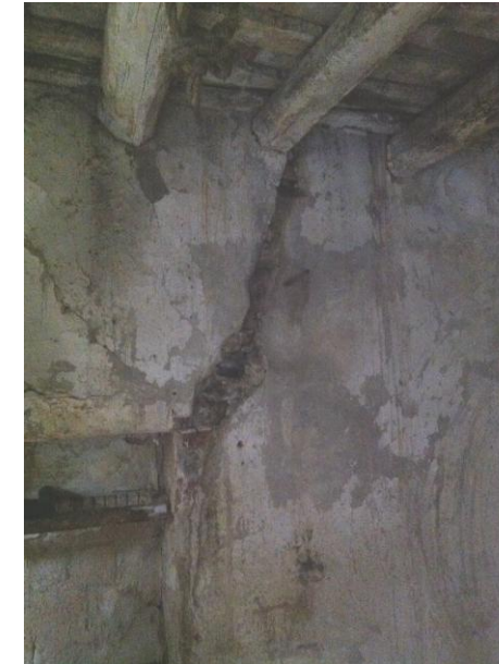
Imatge 48: erosió localitzada a la cuina dels masovers.
