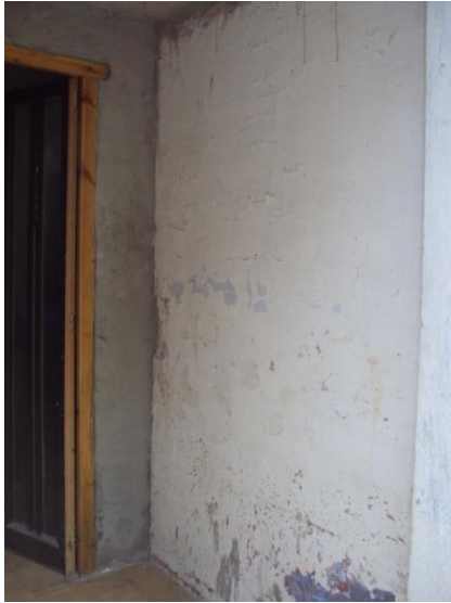
Imatge 37: fissures paret entrada senyors
