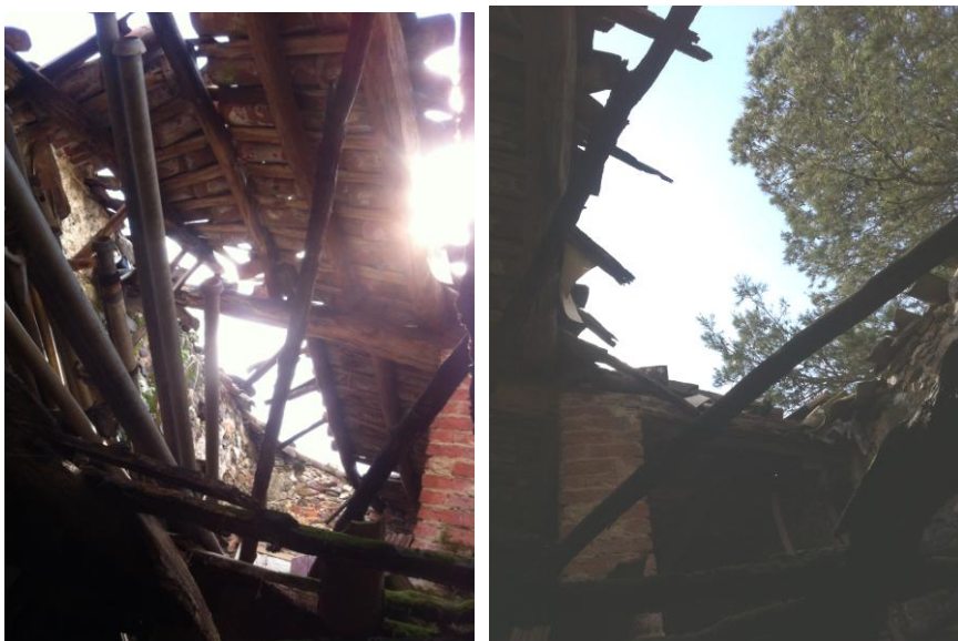
Imatge: estat interior quadres.
