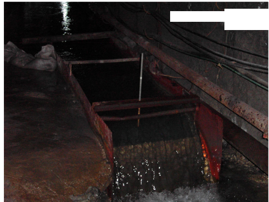
照片 2. 量水堰出水情形
