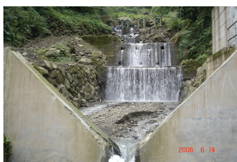
照片 10 2006 年六九大豪雨事件（六九水災）侵襲期間溪頭量水堰遭土石流入侵堆積
