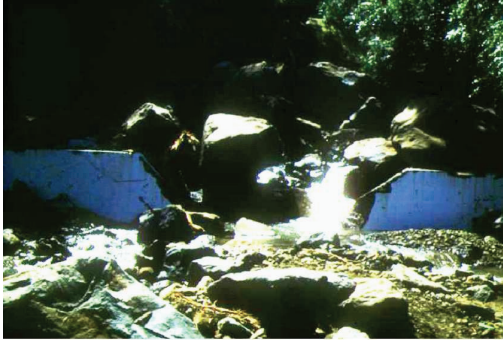
照片 3 1989 年莎拉颱風（九一二水災）侵襲期間溪頭量水堰遭土石流入侵堆積
