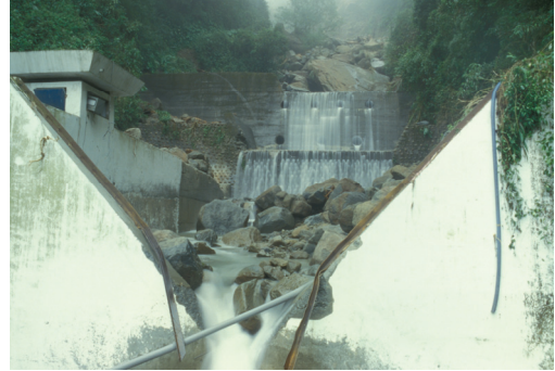
照片 6 1996 年賀伯颱風侵襲期間溪頭量水堰遭土石流入侵堆積
