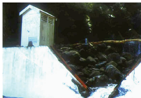
照片 1 1988 年八一四大豪雨事件侵襲期間溪頭量水堰遭土石流入侵堆積
