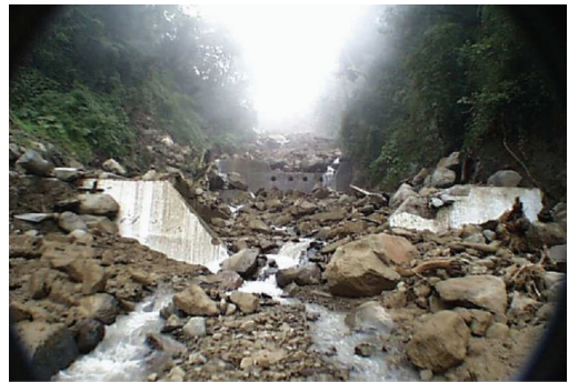
照片 7 2001 年桃芝颱風侵襲期間溪頭量水堰遭土石流入侵堆積
