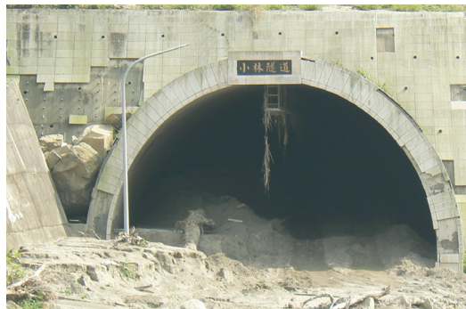
(c)小林隧道另一邊出口一樣卡有枯草及細沙堆積
