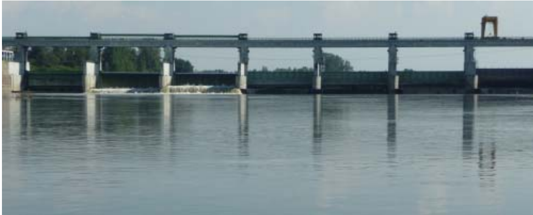
Figura 2.3.2.: Traversa da valle, a regime minimo di deflusso, con solo due paratoie alzate.
