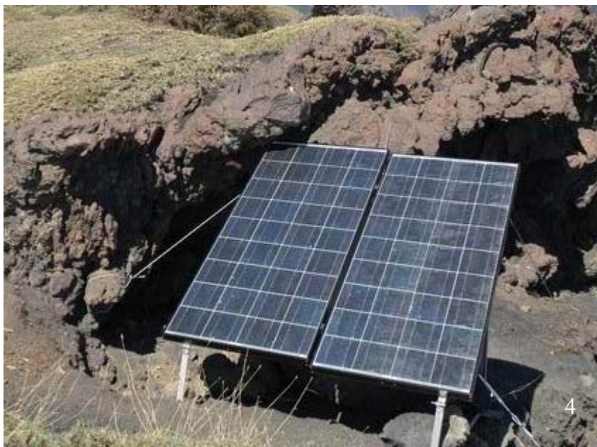
Fig. 4. Telaio con i due pannelli fotovoltaici Kyocera.
