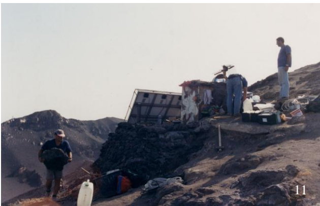
fig.10 – 11 Svolgimento dell'opera di ristrutturazione allo shelter in località Il Pizzo Sopra La Fossa a Stromboli
