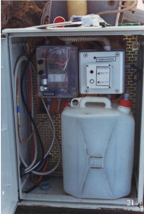
Fig.21 Contenitore della Lengrand con all'interno: quadro di derivazione secondario, pompa lavavetro e bidone da 30 lt. d'acqua
