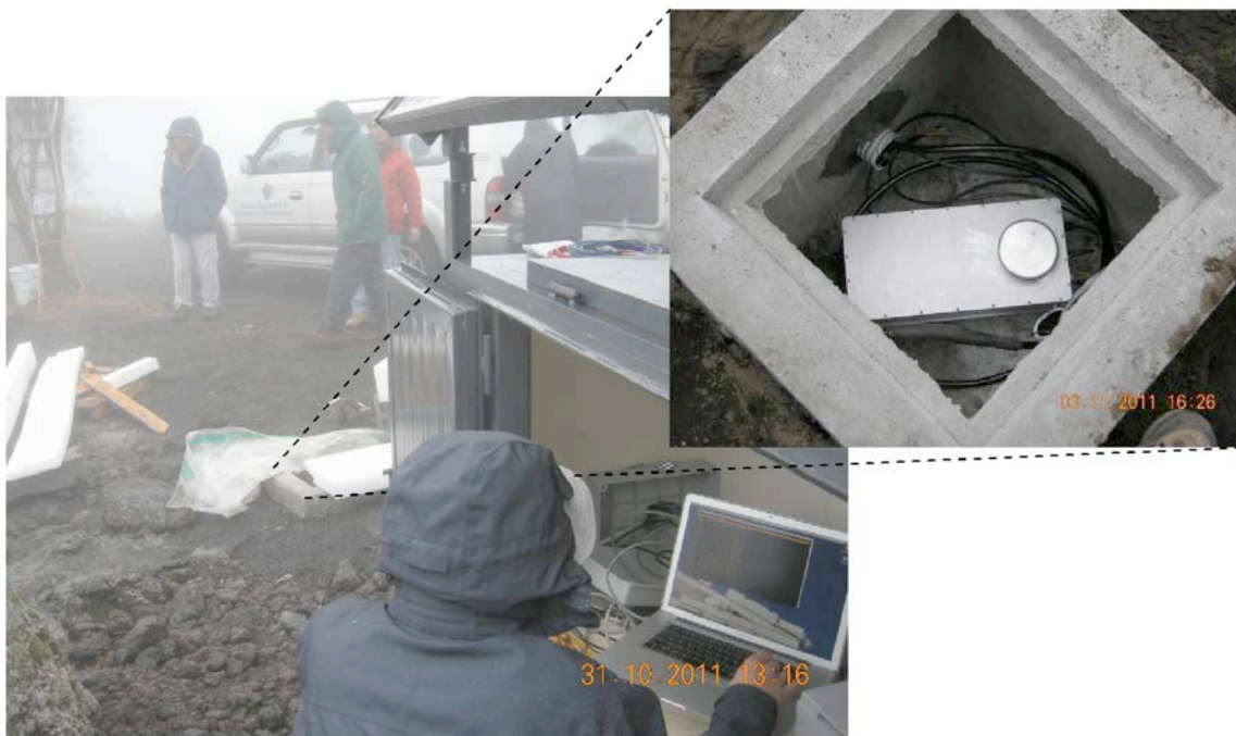
Figura 4. L'aspetto esterno dell'elettronica di controllo (Shoebbox) e la sua tipologia di ubicazione nel sito remoto.
