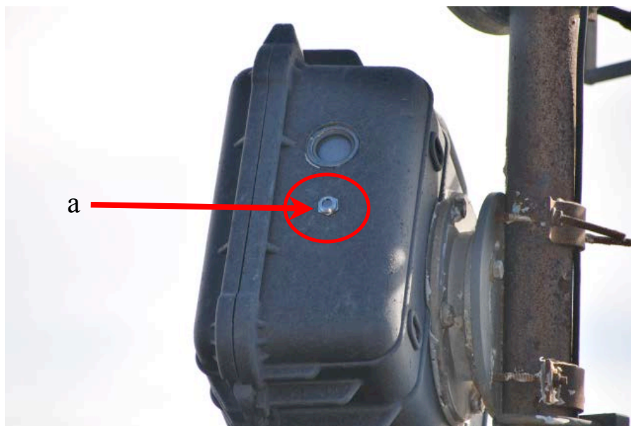
Figura 7. Il radiometro contenuto in un contenitore stagno del tipo “Peli case”, installato sulla struttura del pannello solare della stazione EBEL, con il sensore ottico (a) posto nella parte frontale del box con installata la lente protettiva.
