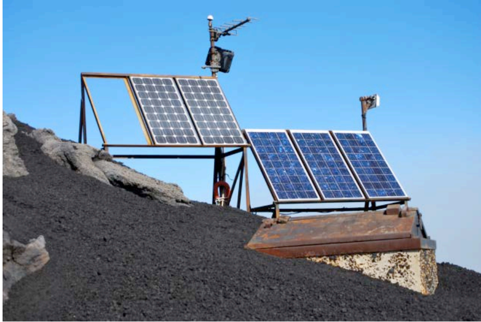
Figura 6. Sistema di alimentazione a pannelli solari della stazione multiparametrica EBEL (sismica, infrasonica, radiometrica) installata presso il Belvedere.
