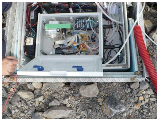
Figura 8. Particolare della stazione di monitoraggio.
