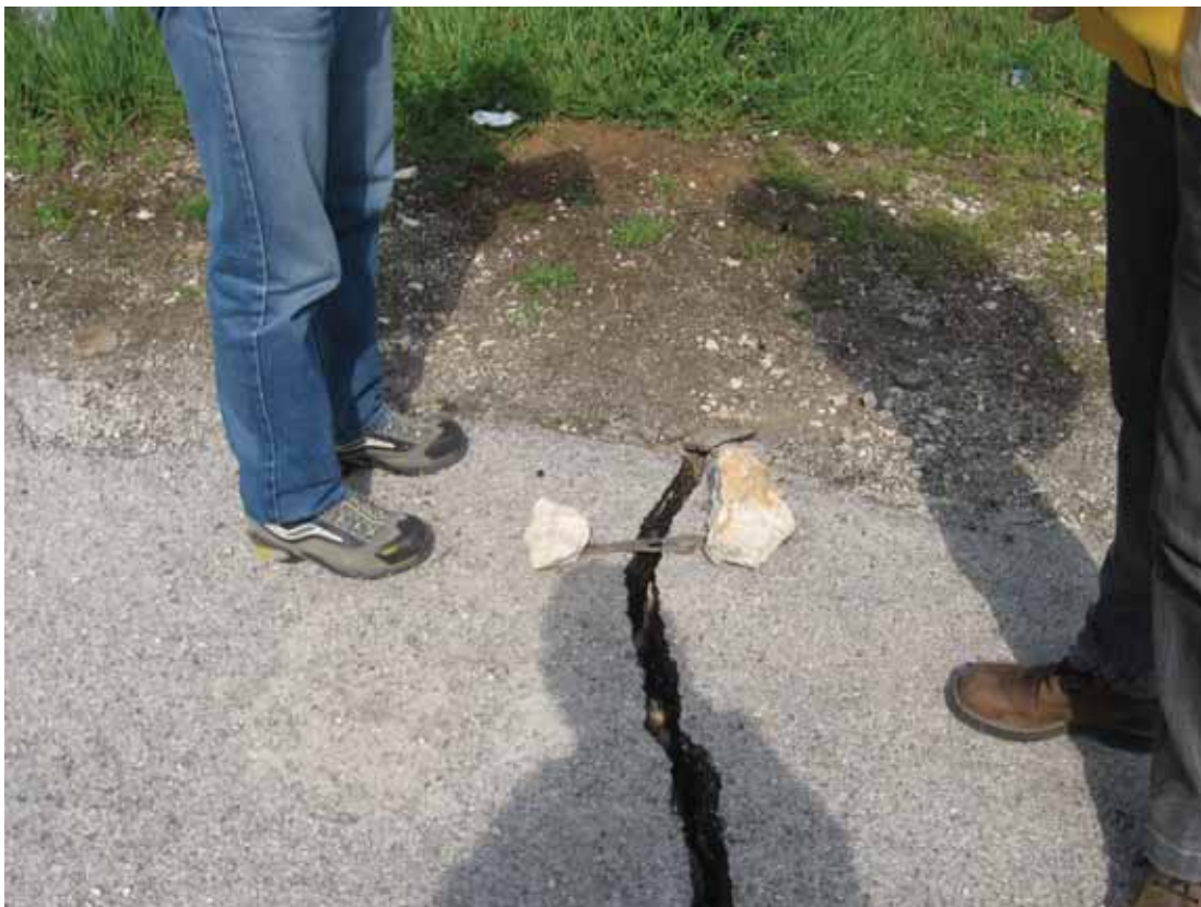
Frattura sulla strada per Bazzano Fracture on the road to Bazzano
