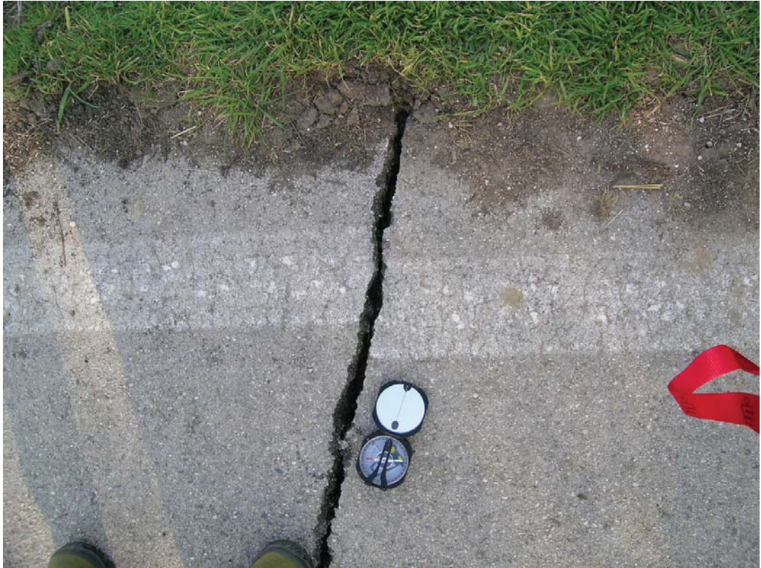
Figura 54 Frattura con dislocazione orizzontale nel manto stradale (WPT MT4, 42.3244/13.4779). Figure 54 Fracture with horizontal displacement in the road pavement (WPT MT4, 42.3244/13.4779).
