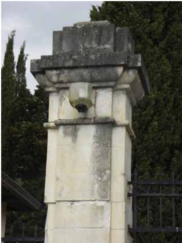
Cimitero di Fossa, blocchi del pilastro disassati Fossa cemetery, pillar blocks shifted and rotated
