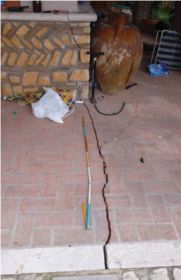
Figura 9 Frattura che interessa il pavimento di un'abitazione presso Paganica. Figure 9 Break affecting the floor near Paganica.
