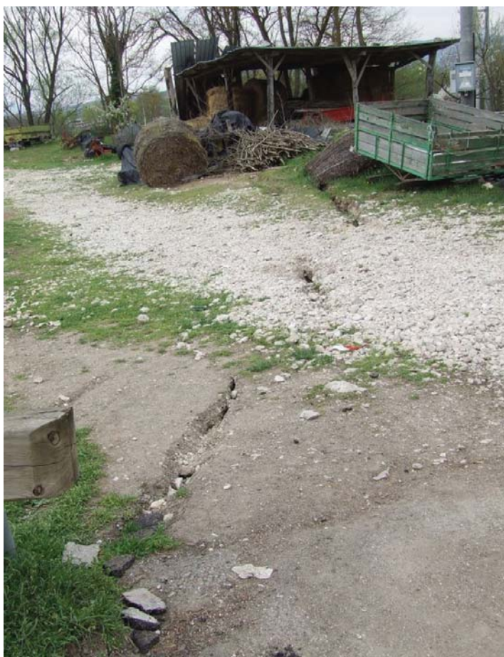
Figura 50 Fratture in sponda sinistra del Fiume Aterno, nei pressi di Onna (WPT RN7, 42.3244/13.4773; WPT MT4, 42.3244/13.4779).
