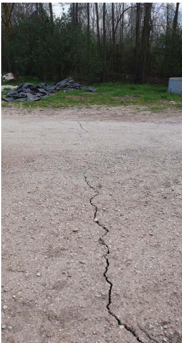
Figura 7 Frattura che interessa la strada nei pressi di Tempera. Figure 7 Rupture on unpaved road close to Tempera.
