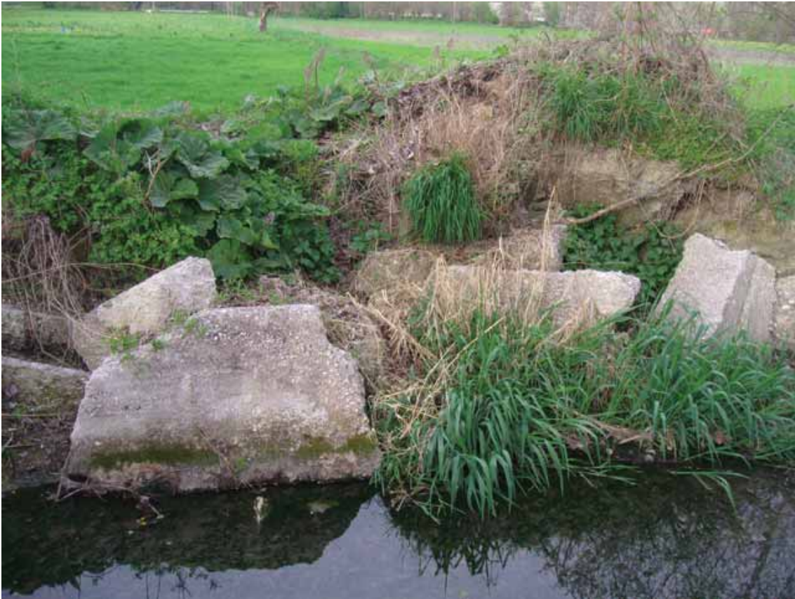
Fossa, rottura su canalizzazione Fossa, breaks in a water ditch
