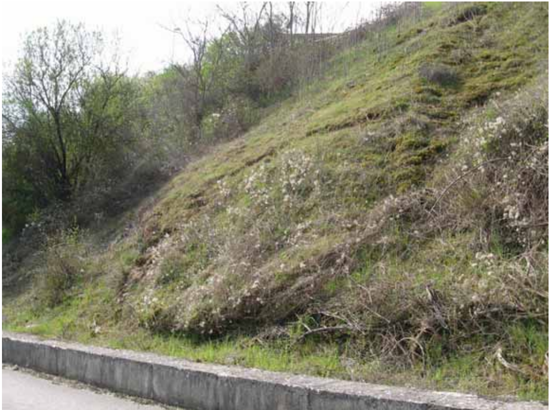
Frana in roccia lungo la strada per Bazzano Rock fall on the road to Bazzano
