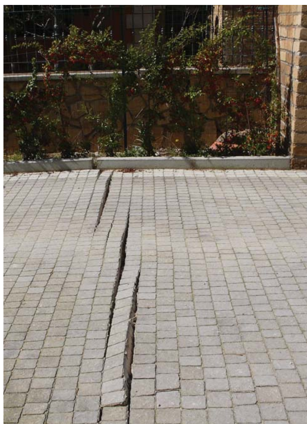
Figura 8 Frattura che disloca un pavimento ed un muro di recinzione nei pressi di Paganica.
