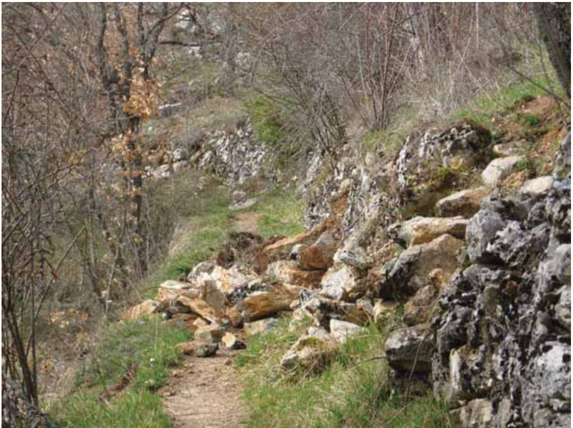
Collebrincioni, crollo in muro di contenimento Collebrincioni, collapse in a retaining wall
