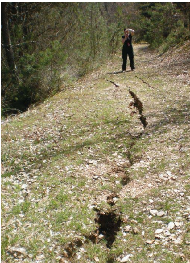
Figura 33 Fratture sul piano di calpestio di una mulattiera, lunghezza totale di ~16 m, max apertura di ~15 cm, ribassamento verso NE con max rigetto verticale pari a ~25 cm (WPT RN3a42.3156/13.4111).
