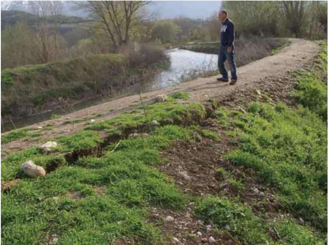
Fossa stazione, argine sull'Aterno Station of Fossa, bank on the Aterno river
