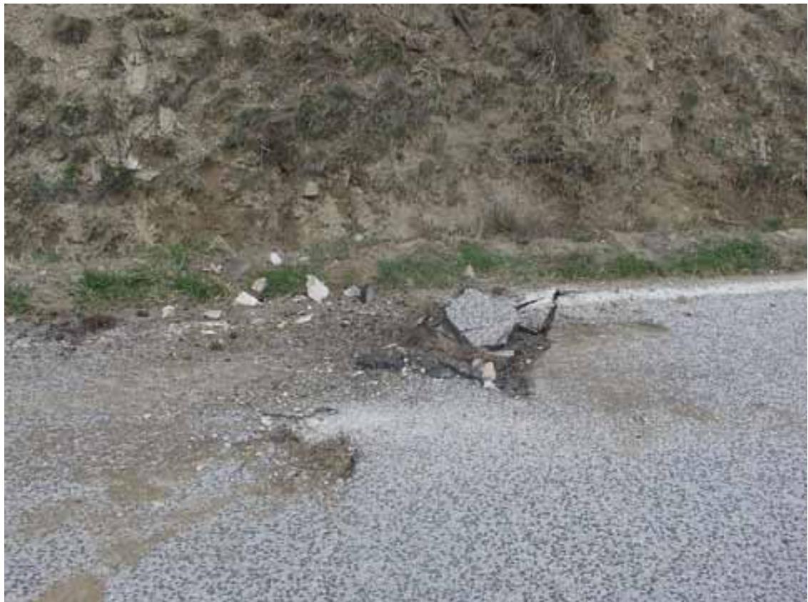
Casamaina, deformazioni su asfalto Casamaina, deformations on the paved road
