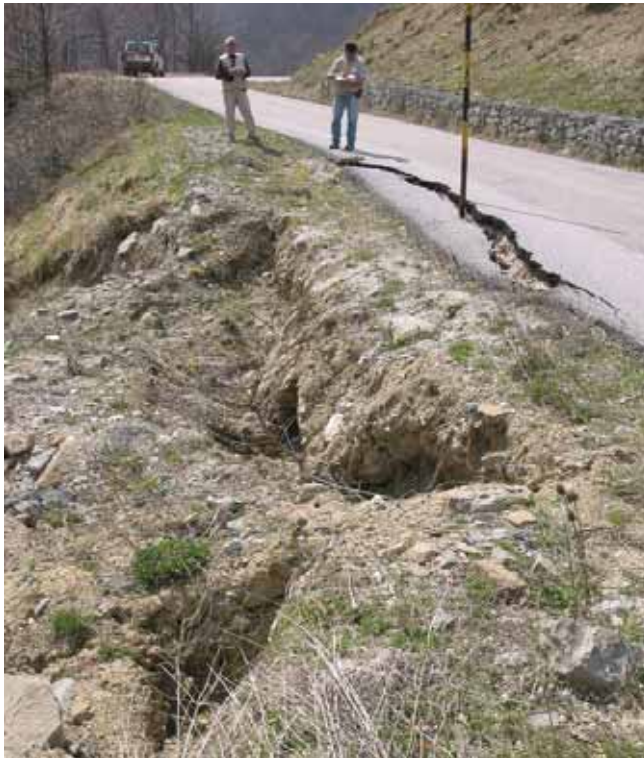
Ortolano, riattivazione di frana Ortolano, landslide reactivation
