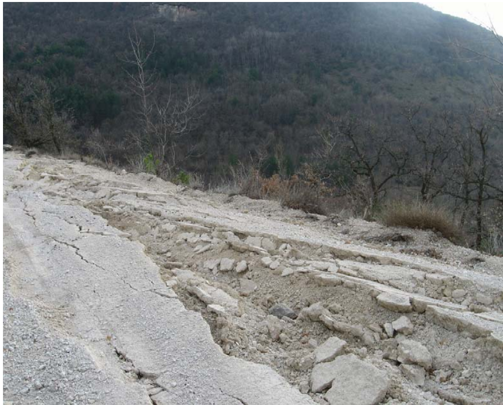
Figura 19 Fratture e scoscendimenti del rilevato della strada che porta ai piedi della Faglia del Monte Stabiata (a monte del WPT 151).
