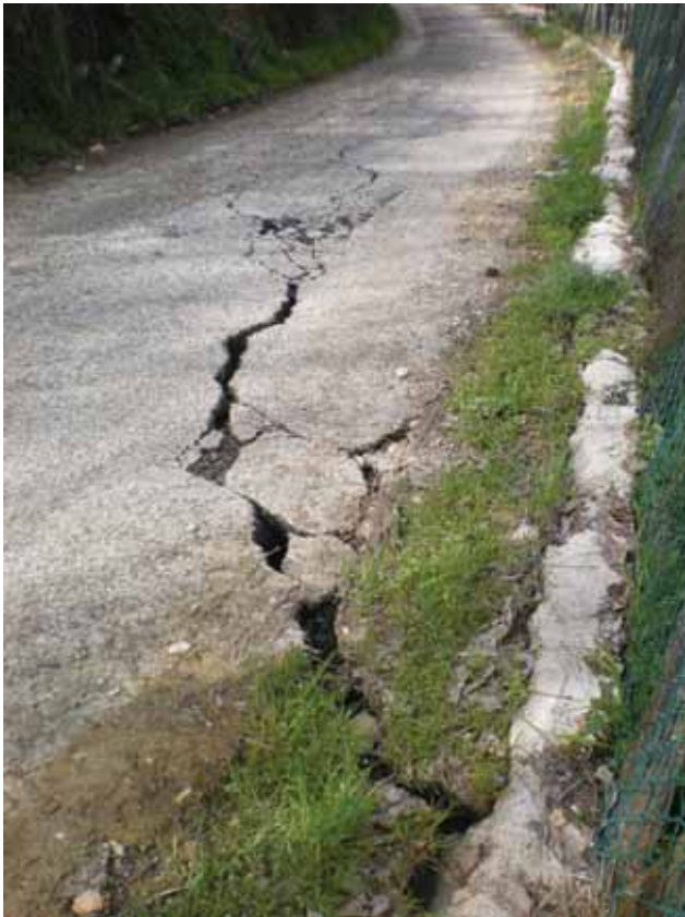
Bagno Grande, frattura su asfalto Bagno Grande, break in the paved road
