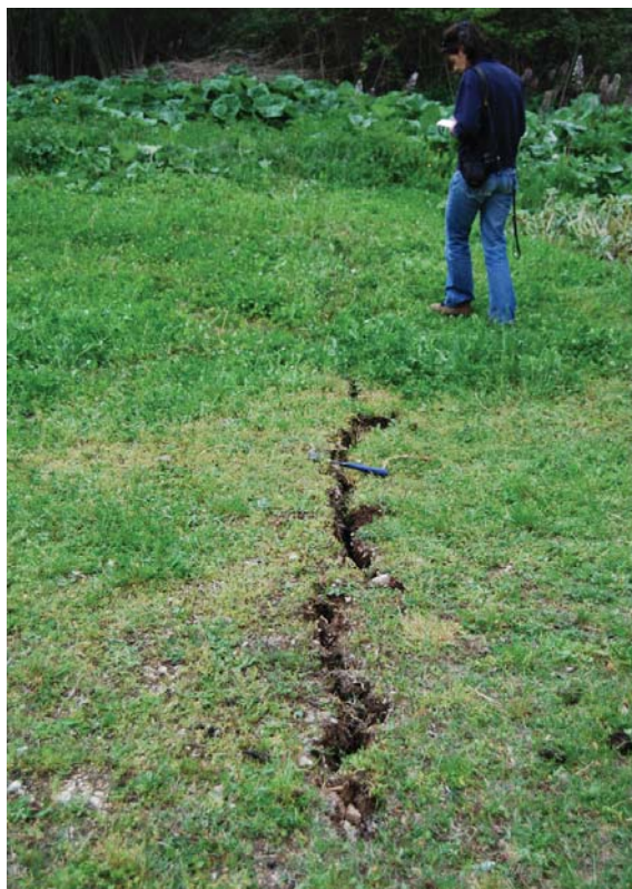
Figura 15 Località Ristorante "Assunta", WPT 131 e 132. Figure 15 Ruptures near Ristorante "Assunta", by WPT 131 and 132.
