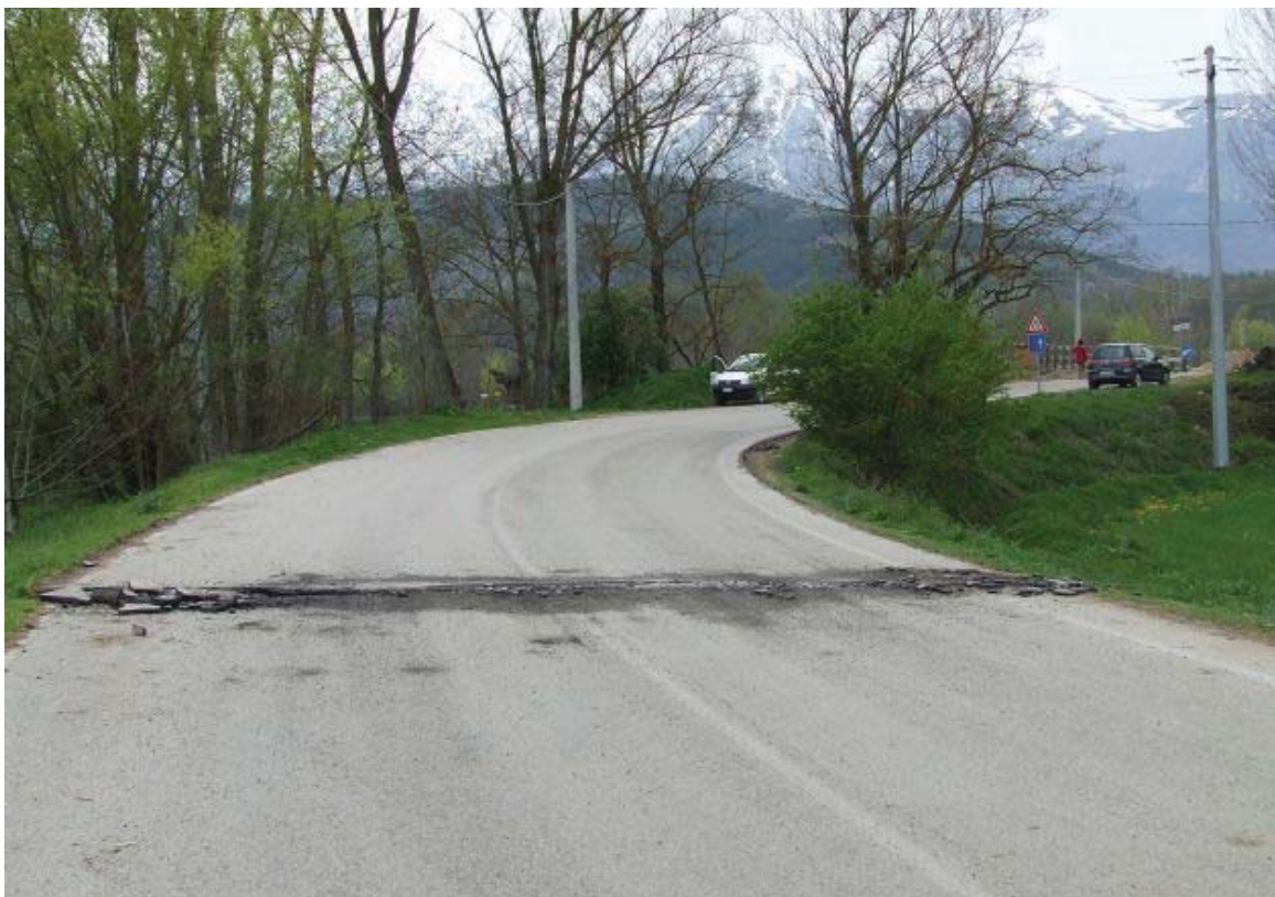
Figura 51 Fratture nel manto stradale sulla strada provinciale Monticchio-Onna, WPT RN6, 42.3244/13.4784. Figure 51 Breaks on the paved road Monticchio-Onna WPT RN6, 42.3244/13.4784.
