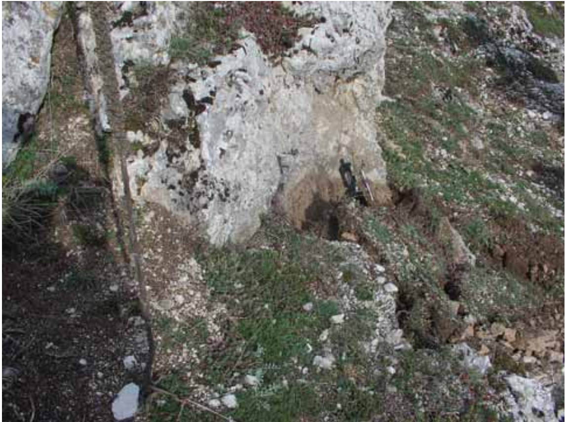
Dissesto nel detrito di versante Failure in the debris
