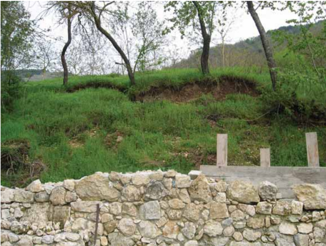
Fossa, distacco di suolo su taglio artificiale Fossa, detachment of the soil in an artificial cut
