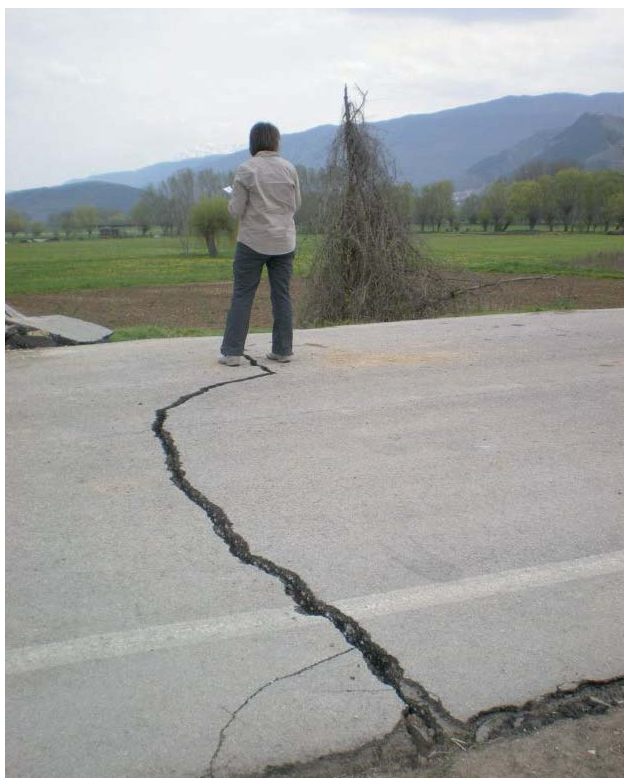
Figura 52 Frattura nel manto stradale in sponda destra del Fiume Aterno, WPT RN8, 42.3233/13.4777. Figure 52 Breaks on the paved road by the right bank of the river Aterno, WPT RN8, 42.3233/13.4777.
