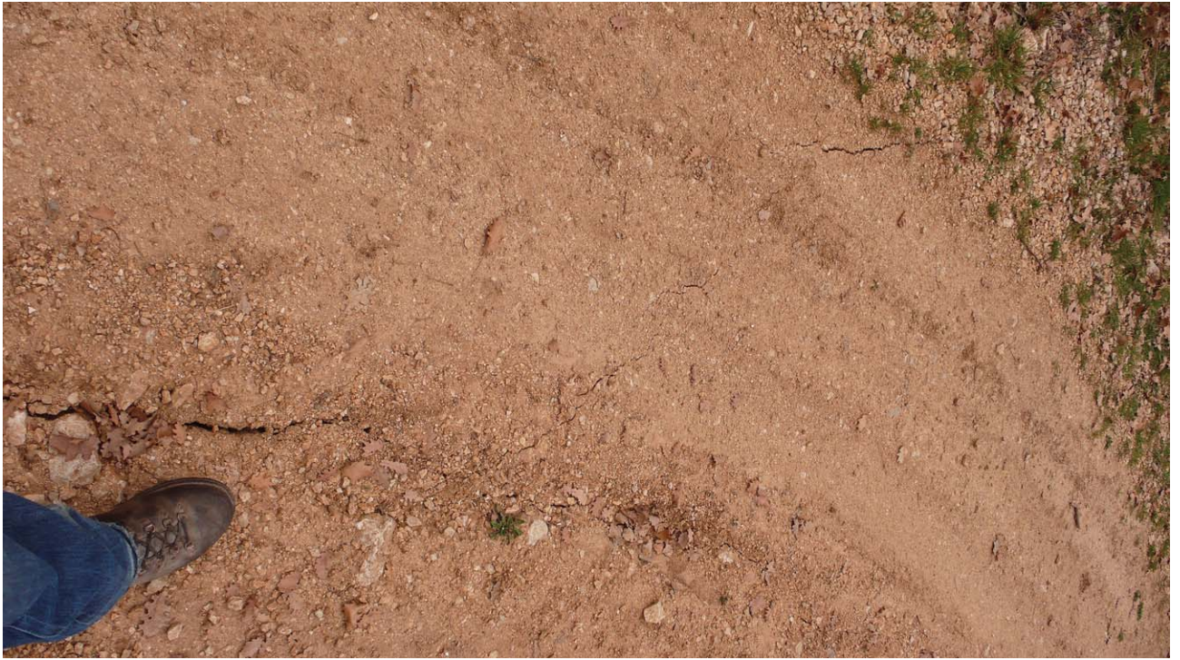
Figura 12 Frattura che interessa una strada sterrata in corrispondenza dei piloni dell'autostrada A24, fra Collebrincioni e Aragno. Figure 12 Rupture on unpaved road between Collebrincioni and Aragno.
