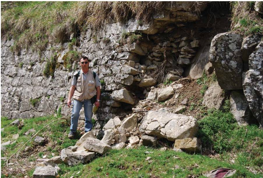
Figura 61 Galleria Ortolano (SS80, km 37): frana del muro a secco. Figure 61 Tunnel "Ortolano" (SS80, km 37): collapse of part of a dry-stone wall.
