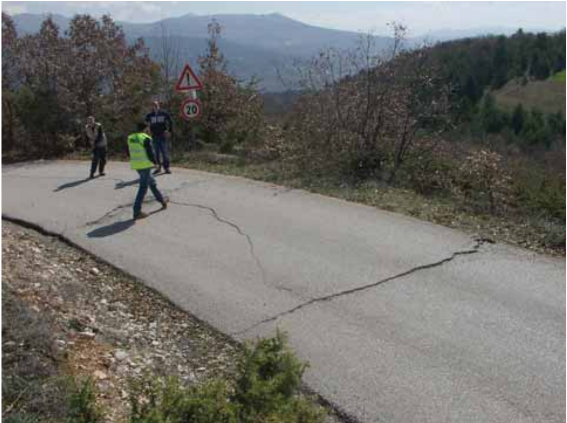
San Giacomo, frattura su asfalto San Giacomo, break on paved road
