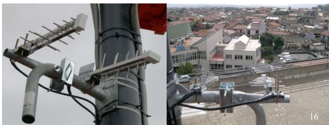
Figura 16. Le due antenne di trasmissione installate sul palo fissato sul tetto della scuola media che puntano la sede dell'I.N.G.V. di Nicolosi.
