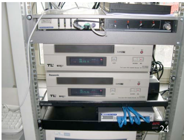
Figura 24. Il sistema di videoregistrazione analogico mediante apparati time-lapse.
