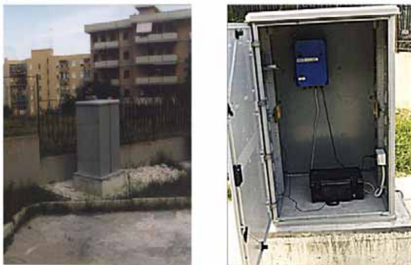
Figura 2.2: Una nuova stazione accelerometrica: a) vista esterna; b) interno della postazione.
