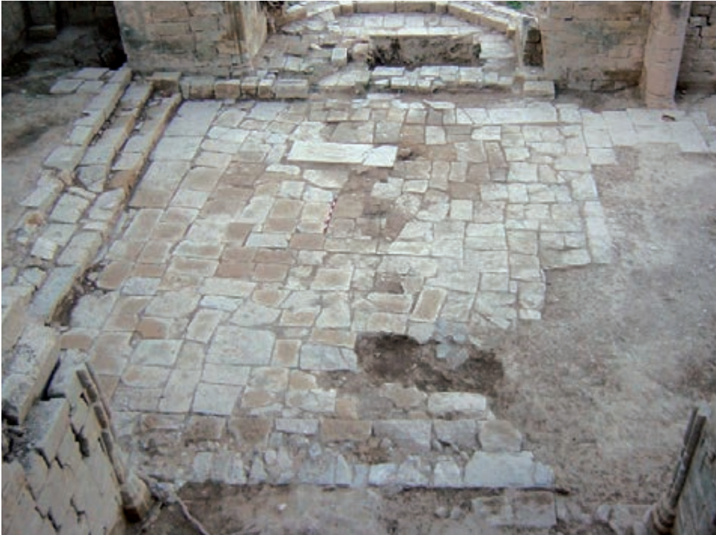
Figura 5. Vista del paviment de la nau de l'església on hi ha dues de les tombes estudiades, cobertes amb làpida esculpida.
