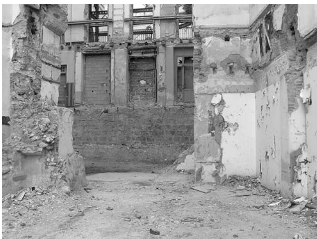
Lámina I. Fotografía de solar al inicio de los trabajos. Vista tomada desde la calle Sant Blai, podemos apreciar el desnivel existente con la fachada de la Placeta del Fossar.
