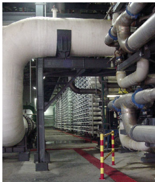
Fig. 4: Interior de una planta desaladora en Ashkelon (Israel). En primer plano la tubería de entrada de agua procedente del mar. Al fondo el conjunto de membranas de ósmosis inversa.
