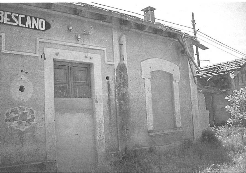
L'estació de Bescanó, juntament amb la d'Anglès i la de Sant Feliu de Pallerols, presenta un estat de conservació deficient.
