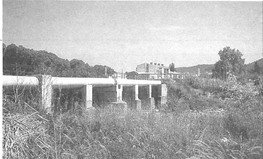
L'antic pont sobre la riera d'Osor, s'ha transformat en suport per a la canalització d'aigua.
