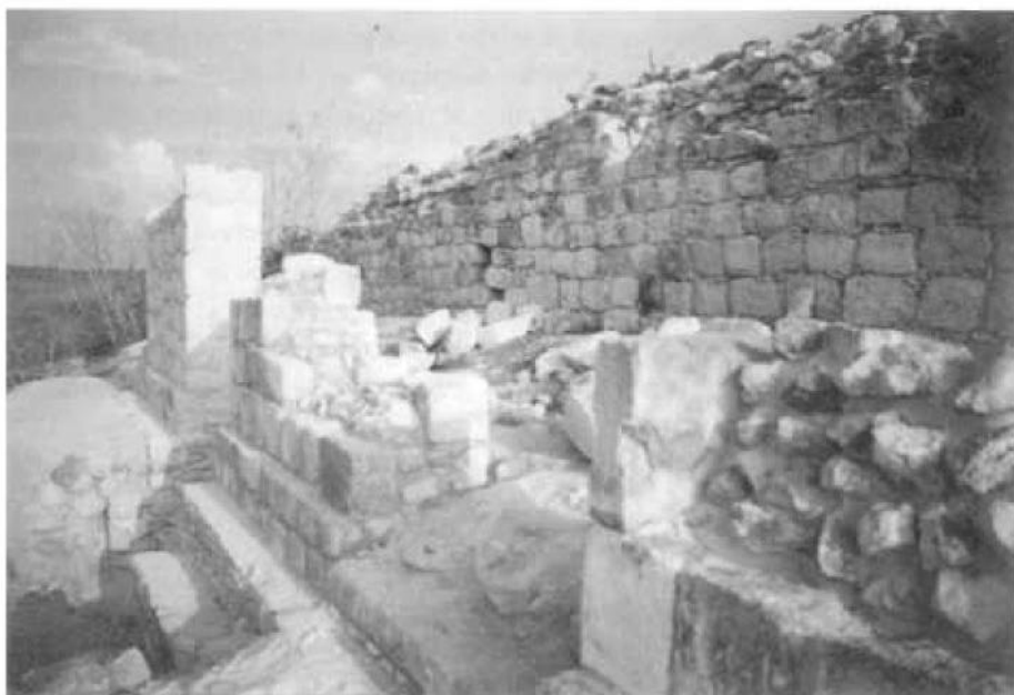
FIGURA 6.—Reposición del muro de la fachada septentrional de la estructura CA-3 (Palacio Pop).
